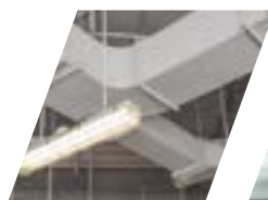
Luchtkanaal- en klimaattechniek
